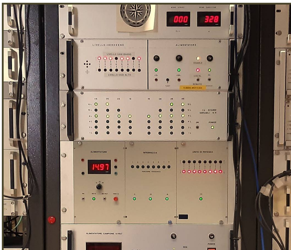
Blocco per Controllo Sfasatori a Kerosene - Rack L (secondo e quarto modulo dall'alto)
