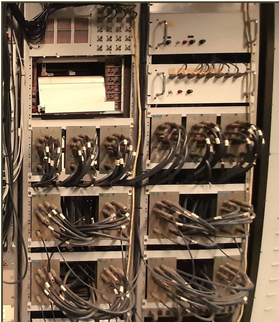
Divisori Ch per Formazione Fasci NS – Rack 27-28
