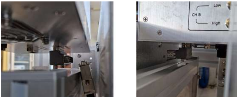
Fig. 2.6: Interferenza meccanica tra connettori e struttura.
