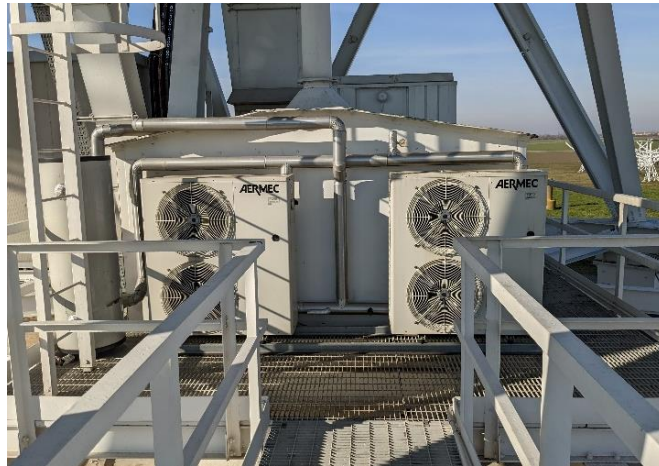
Figura 9 Macchine per refrigerazione acqua a Medicina
